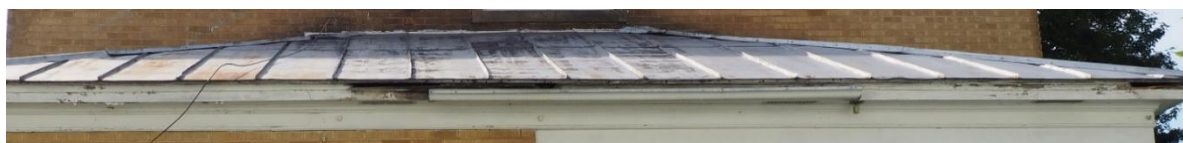
Le revêtement de toiture en tôle pincée
